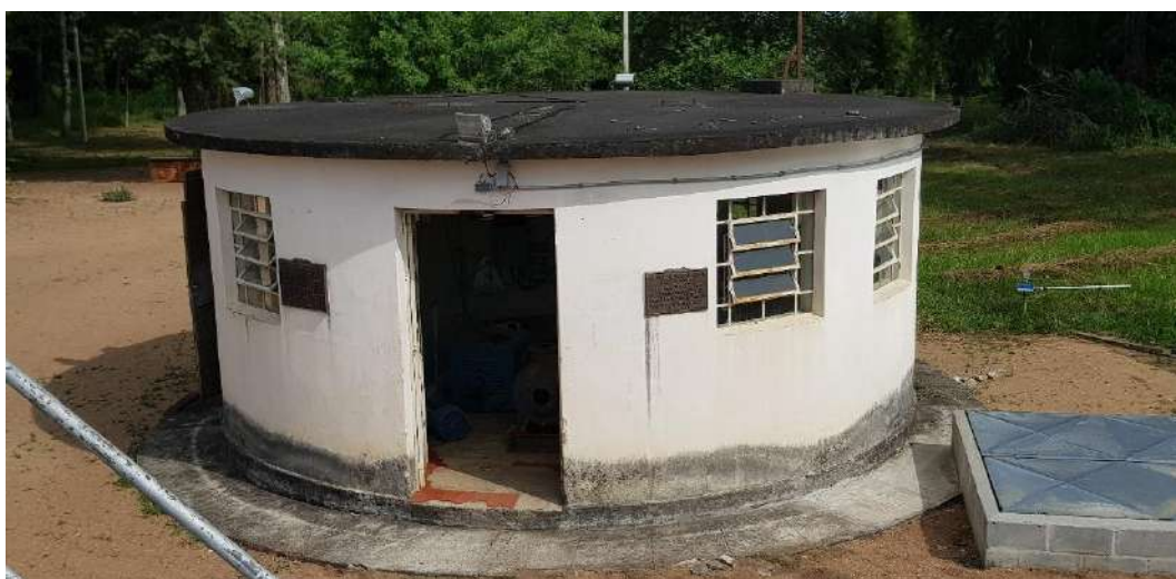
Figura 100 – Casa de Bombas da EEAT 3. Fonte: Biancade Engenharia
