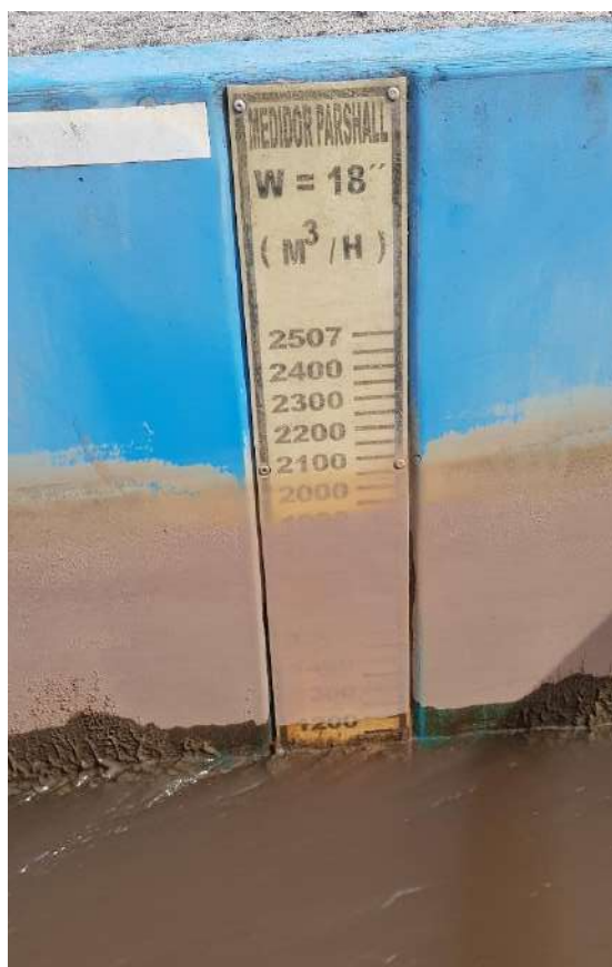
Figura 60 – Canal de Entrada da Água Bruta na ETA. Fonte: Biancade Engenharia
