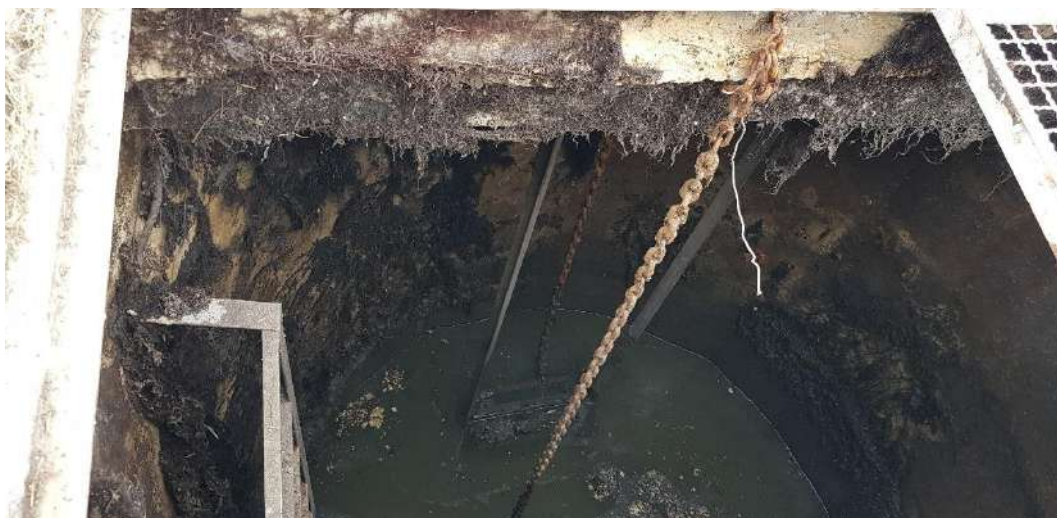
Figura 203 – EEE Vila Bela – Poço de Sucção. Fonte: PDE, 2011
