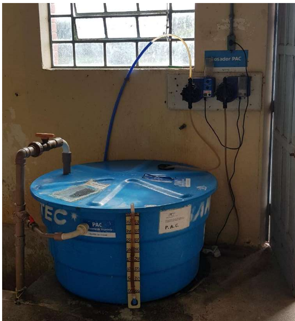
Figura 32 – Caixa Dosadora de PAC. Fonte: Biancade Engenharia
