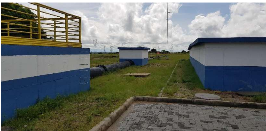
Figura 72 – Adutora de Água tratada. Fonte: Biancade Engenharia
