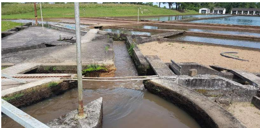
Figura 61 – Pré-Filtros da Estação de Tratamento. Fonte: Biancade Engenharia
