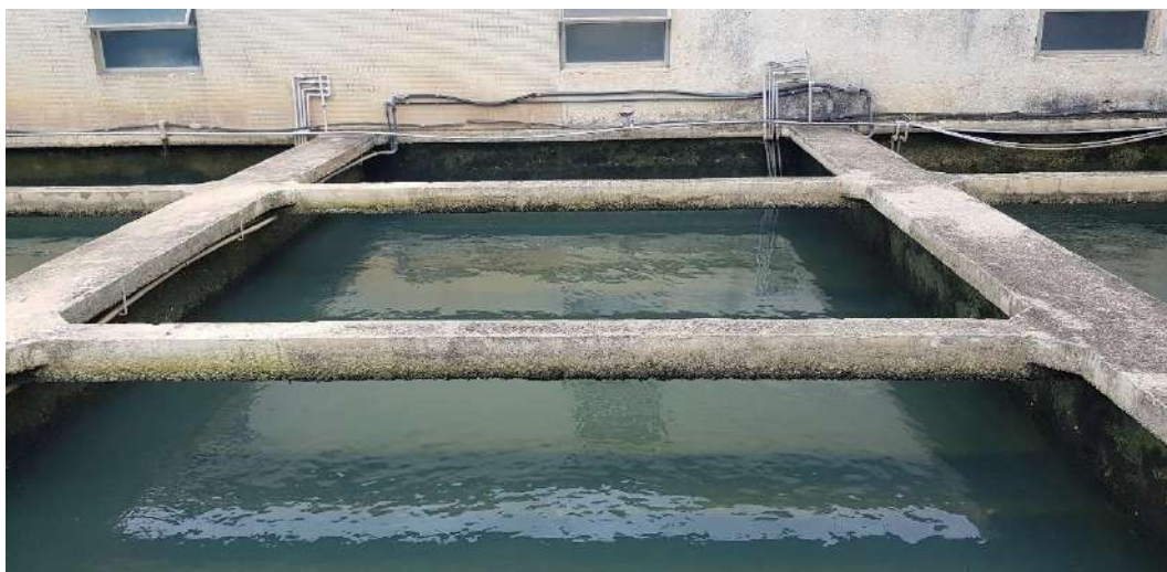
Figura 47 – Filtros de Areia. Fonte: Biancade Engenharia
