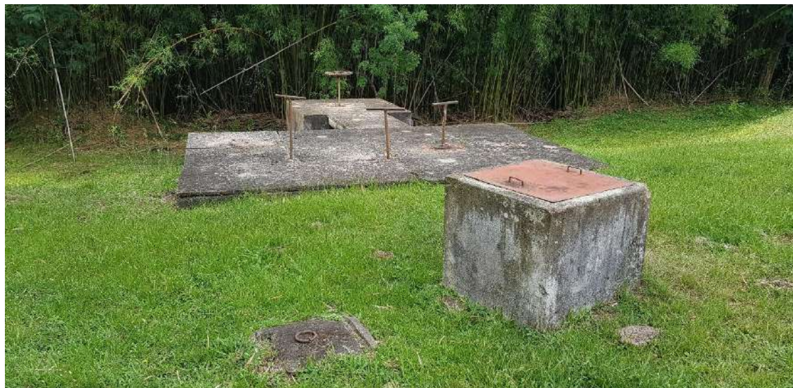
Figura 83 – Caixa de Inspeção. Fonte: Biancade Engenharia
