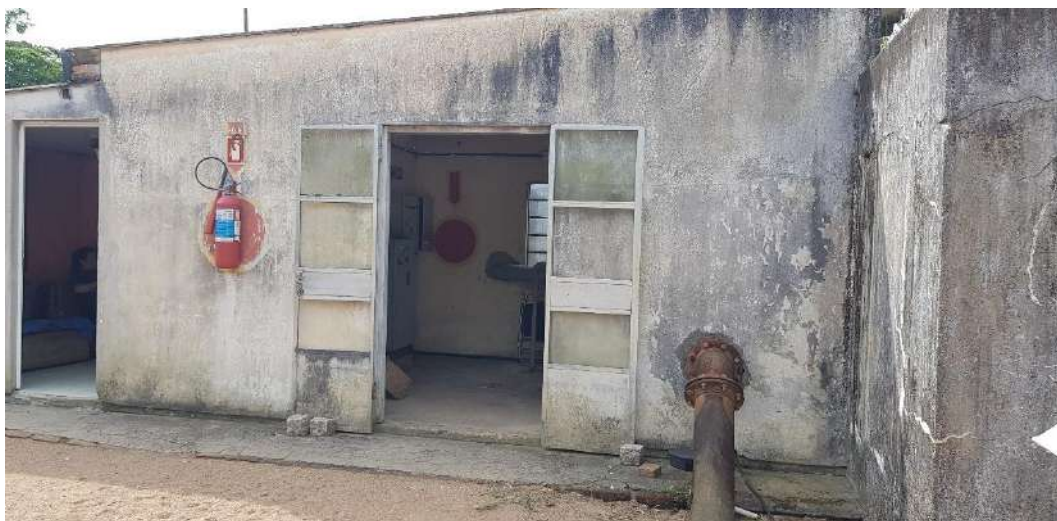
Figura 96 – Casa de Bombas da EEAT 2. Fonte: Biancade Engenharia
