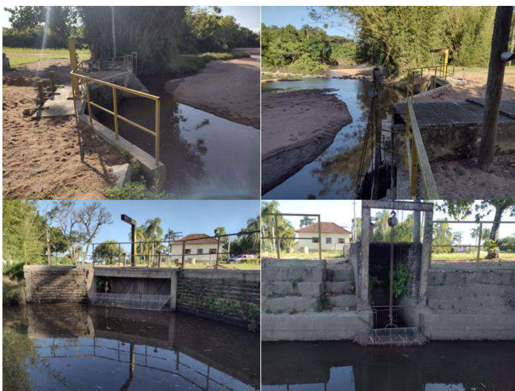
Figura 20 – Tomada de Água Arroio Pelotas. Fonte: PDA, 2014
