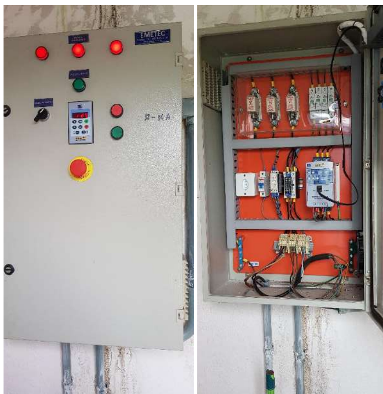
Figura 192 – EEE Ferreira Viana – Quadro de Comandos. Fonte: PDE, 2011
