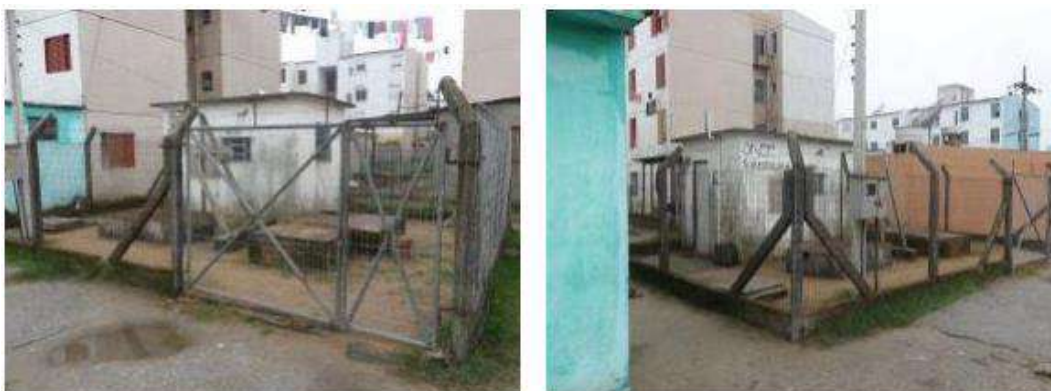
Figura 212 – EEE Cohab Pestano – Estação Elevatória Cohab Pestano. Fonte: PDE, 2011
