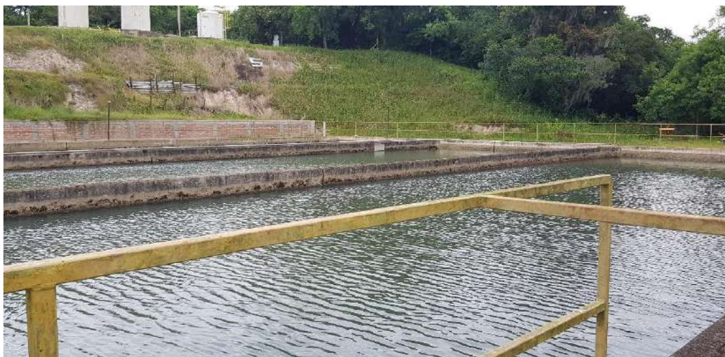
Figura 46 – Decantadores Finais da Estação de Tratamento. Fonte: Biancade Engenharia
