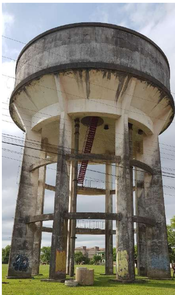
Figura 122 – Reservatório R-10T do Município. Fonte: Biancade Engenharia
