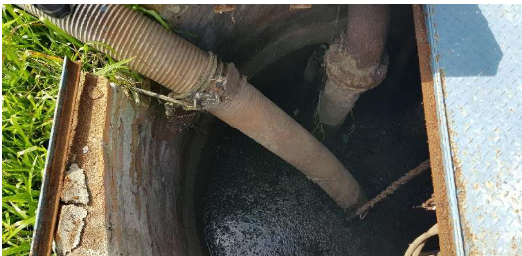
Figura 197 – EEE Rodoviária – Poço de Sucção. Fonte: PDE, 2011
