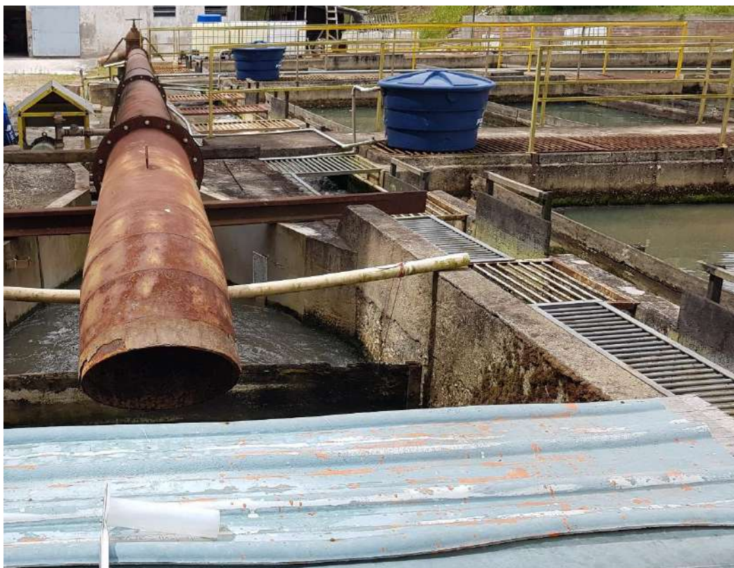
Figura 43 – Chegada da Água Bruta na Calha de Medição 2. Fonte: Biancade Engenharia
