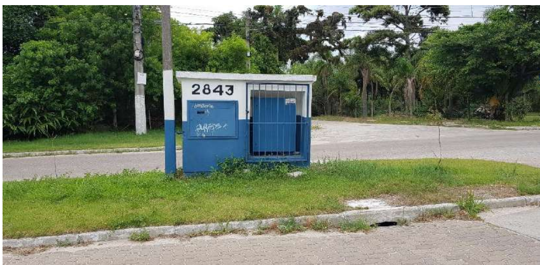
Figura 179 – EEE L2 – Estação Elevatória L2. Fonte: Biancade Engenharia
