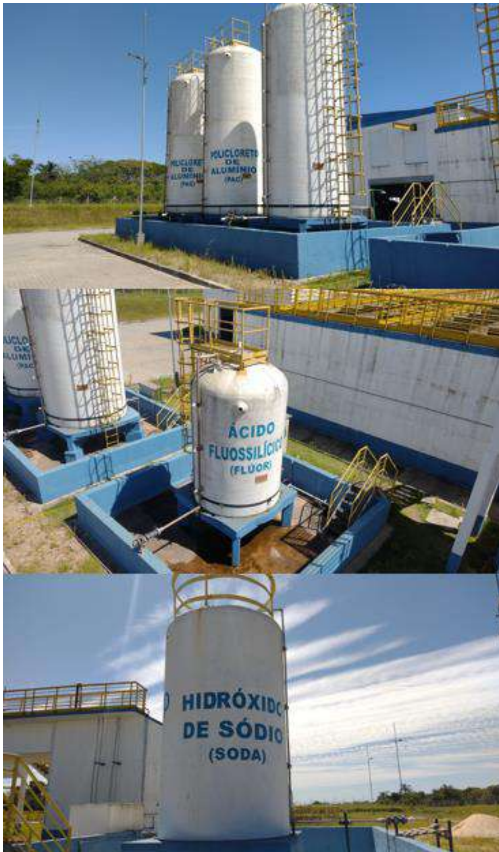
Figura 75 – Tanques ETA São Gonçalo-18. Fonte: Biancade Engenharia
