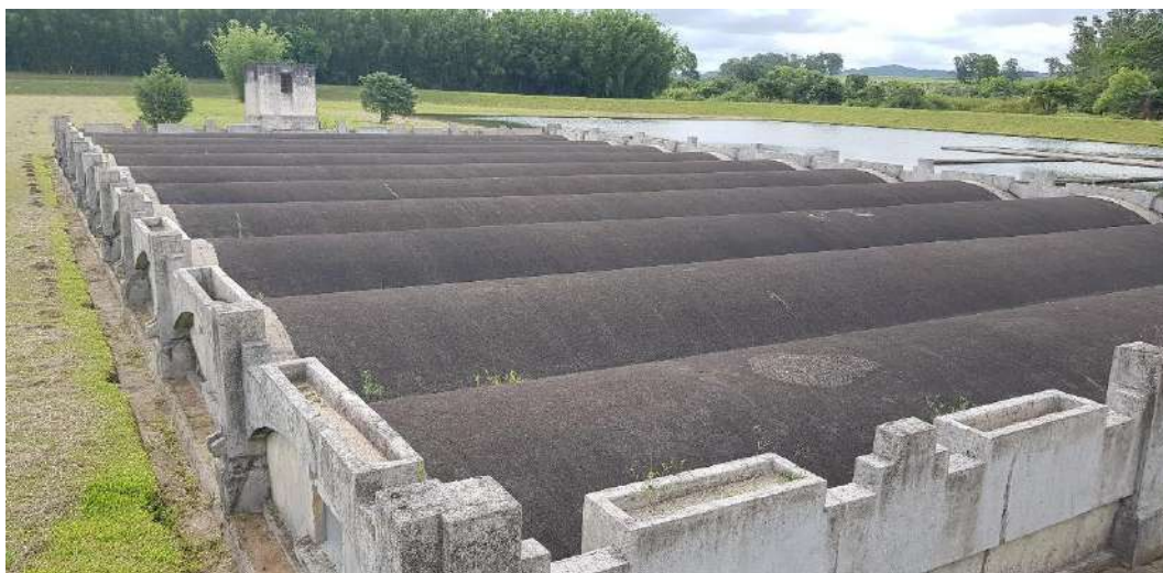
Figura 40 – Reservatório ETA Moreira. Fonte: Biancade Engenharia
