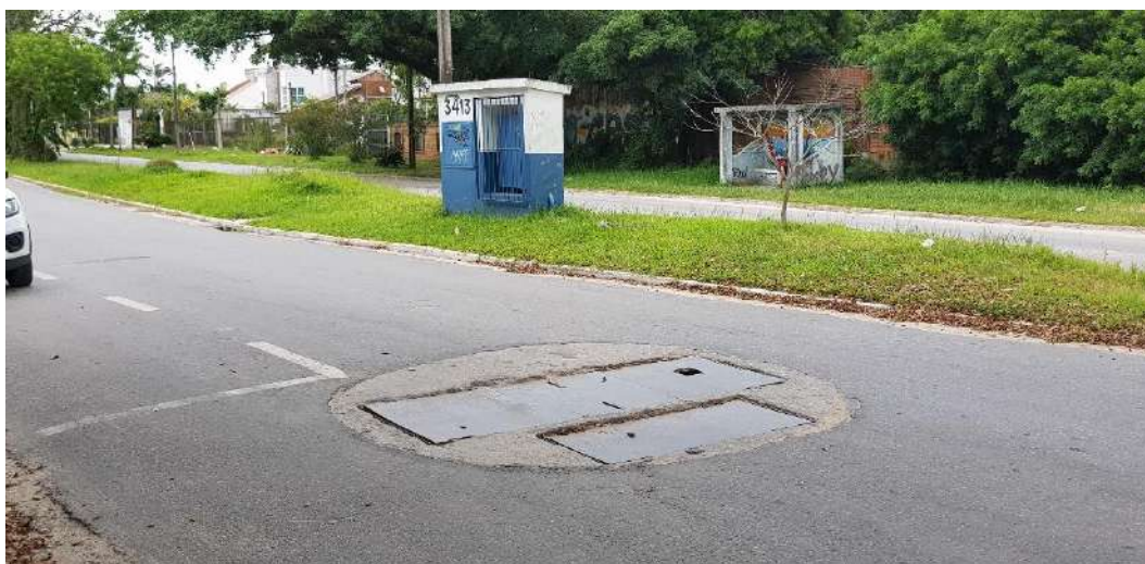
Figura 177 – EEE L1 – Estação Elevatória L1. Fonte: Biancade Engenharia
