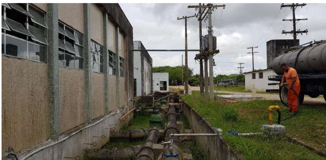
Figura 92 – Adutoras de Água Tratada. Fonte: Biancade Engenharia
