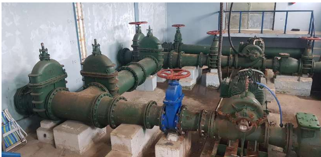
Figura 127 – Conjunto de Motobombas R-15T do Município. Fonte: Biancade Engenharia
