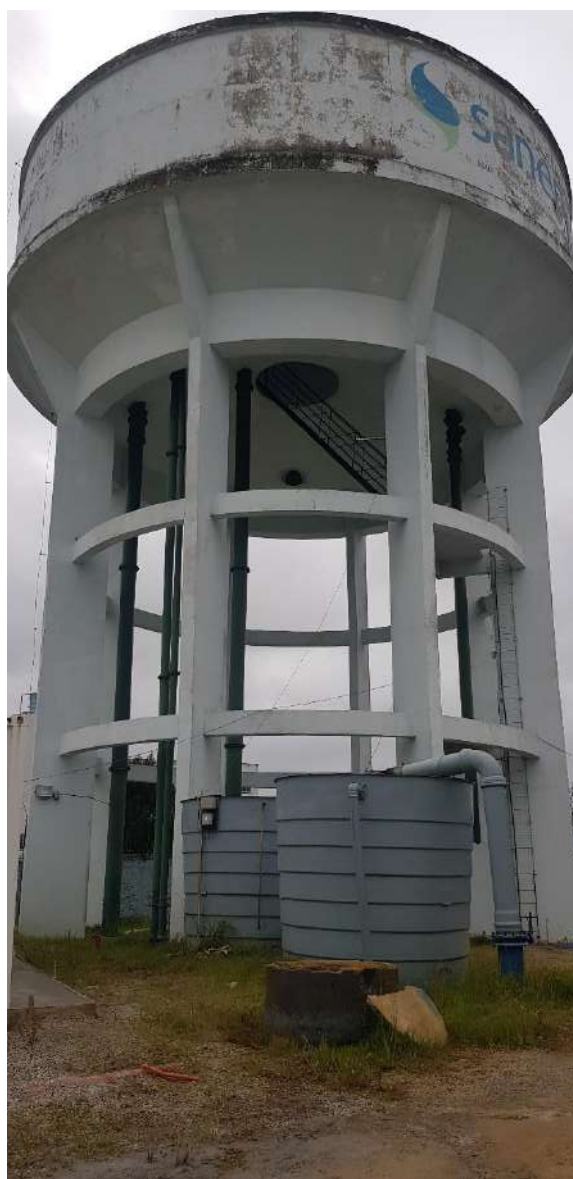
Figura 126 – Reservatório R-15T do Município. Fonte: Biancade Engenharia
