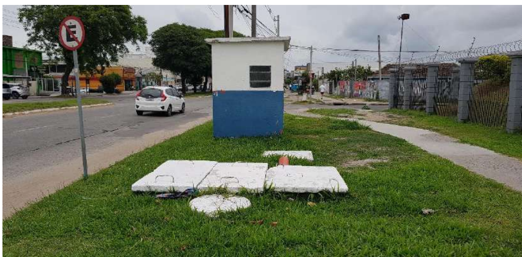
Figura 191 – EEE Ferreira Viana – Estação Elevatória Ferreira Viana. Fonte: PDE, 2011
