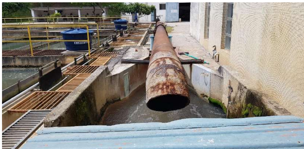
Figura 42 – Chegada da Água Bruta na Calha de Medição 1. Fonte: Biancade Engenharia
