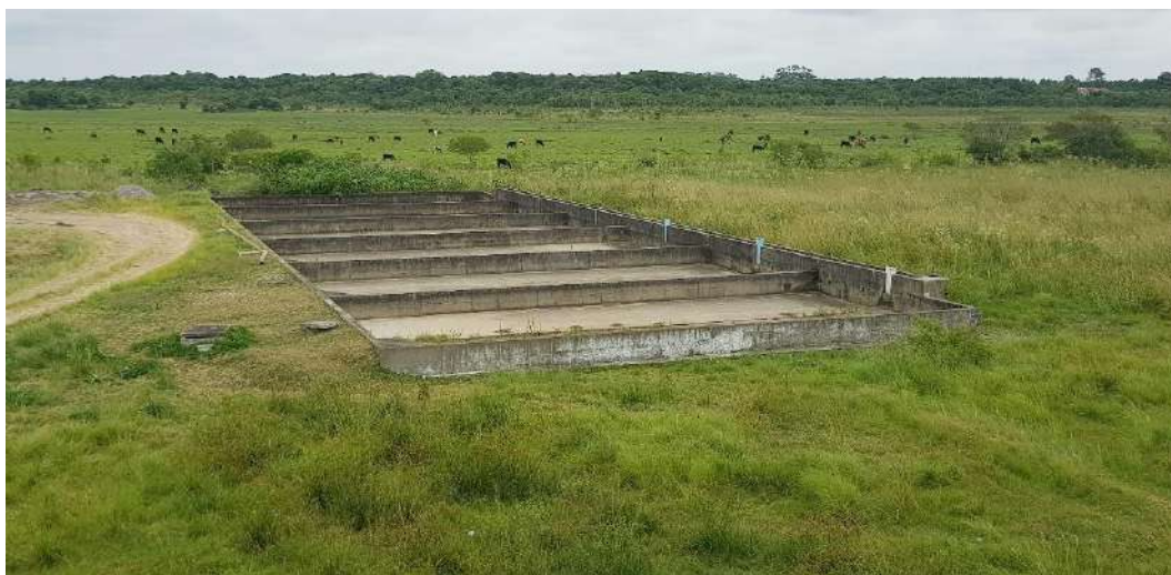
Figura 160 – ETE Laranjal – Leitões de Secagem de Lodo. Fonte: Biancade Engenharia
