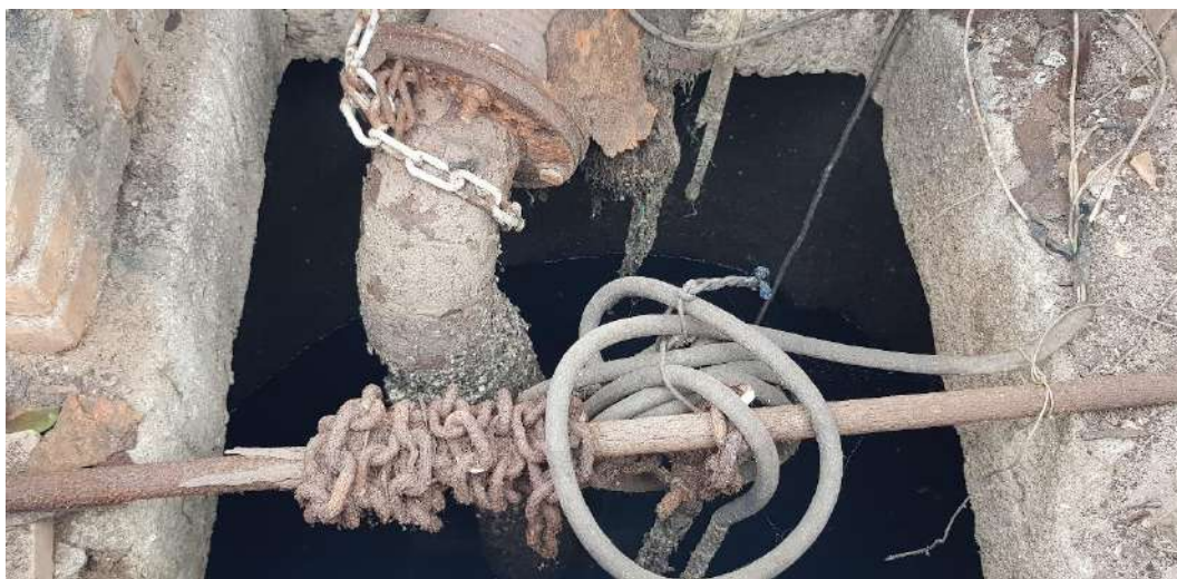
Figura 190 – EEE Fátima – Poço de Sucção. Fonte: Biancade Engenharia
