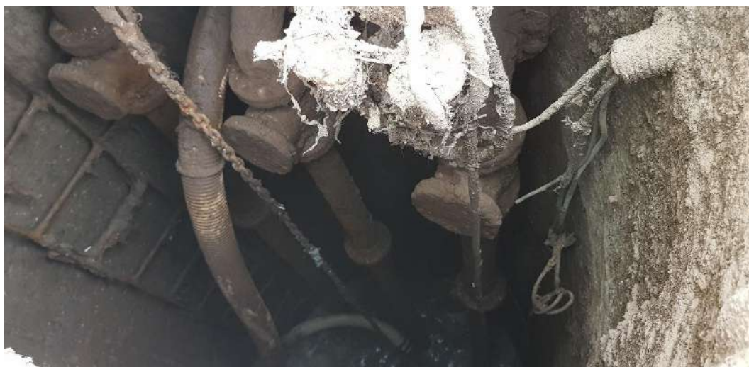
Figura 178 – EEE L1 – Poço de Sucção. Fonte: Biancade Engenharia
