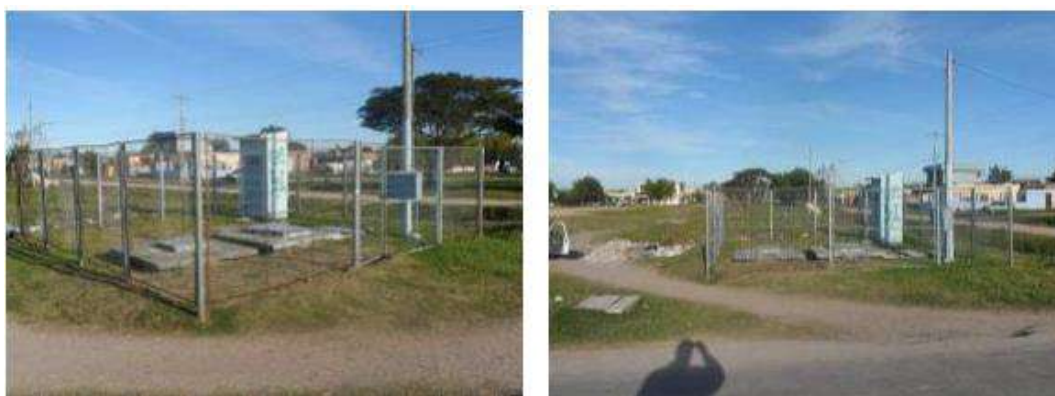
Figura 206 – EEE Meneguetti – Estação Elevatória Meneghetti. Fonte: PDE, 2011
