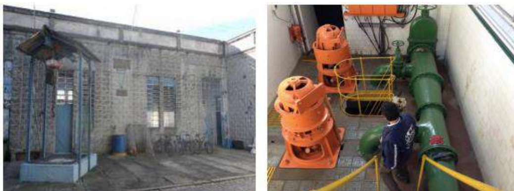
Figura 220 – EEE US-I – Estação Elevatória US-1. Fonte: PDE, 2011
