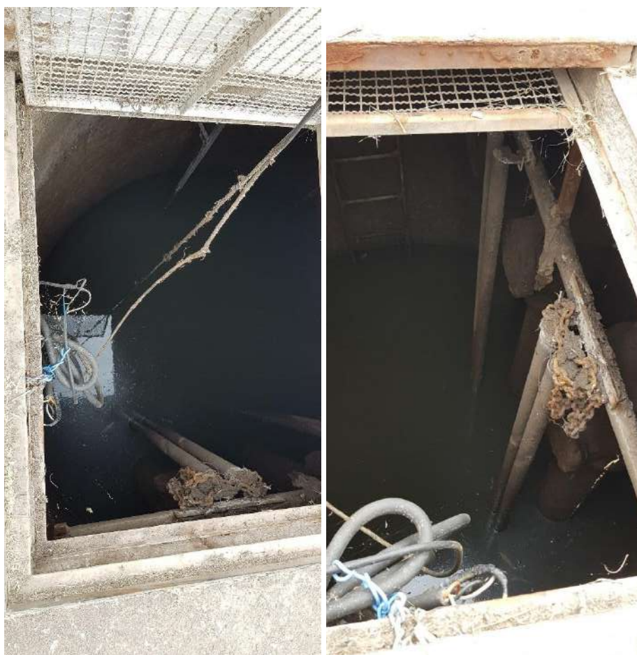
Figura 187 – EEE L5 – Poço de Sucção. Fonte: Biancade Engenharia
