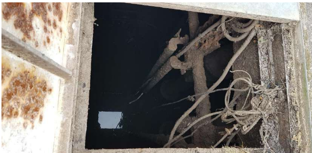
Figura 184 – EEE L3 – Poço de Sucção. Fonte: Biancade Engenharia
