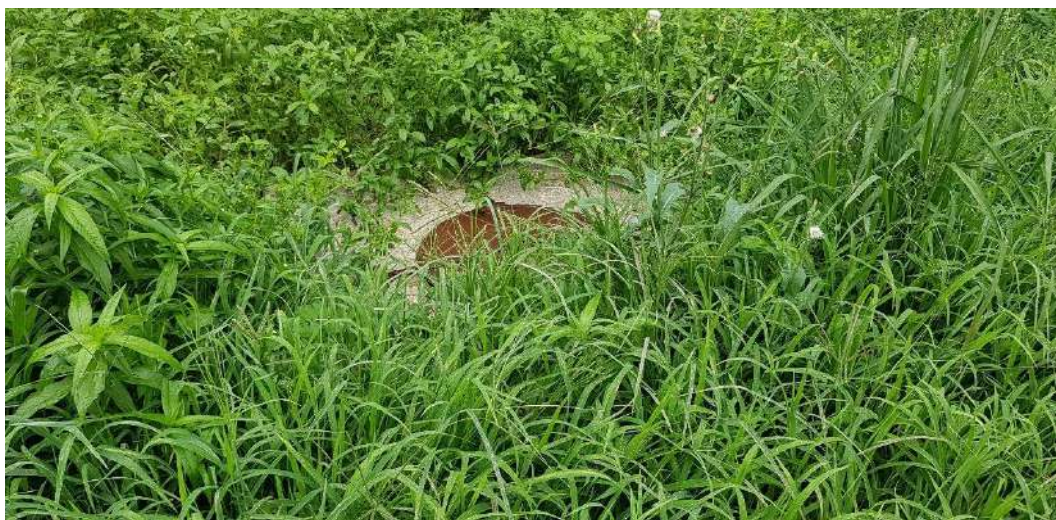
Figura 201 – EEE Vila Judite – Poço de Sucção. Fonte: Biancade Engenharia
