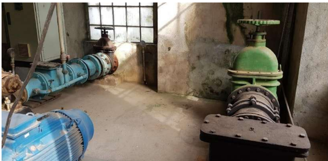
Figura 86 – Saída das Adutoras de Água Tratada. Fonte: Biancade Engenharia
