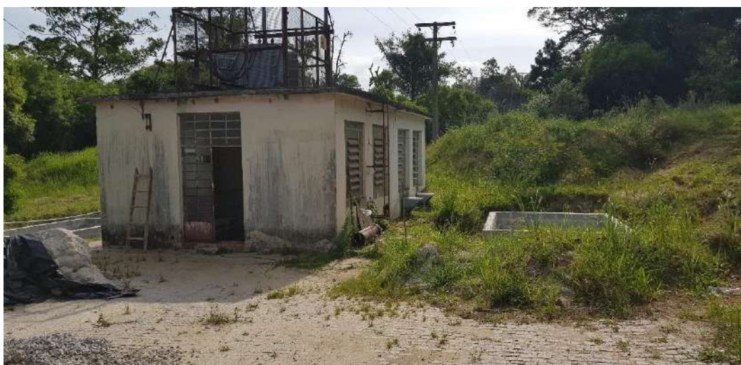
Figura 104 – Casa de Bombas da EEAT 3. Fonte: Biancade Engenharia
