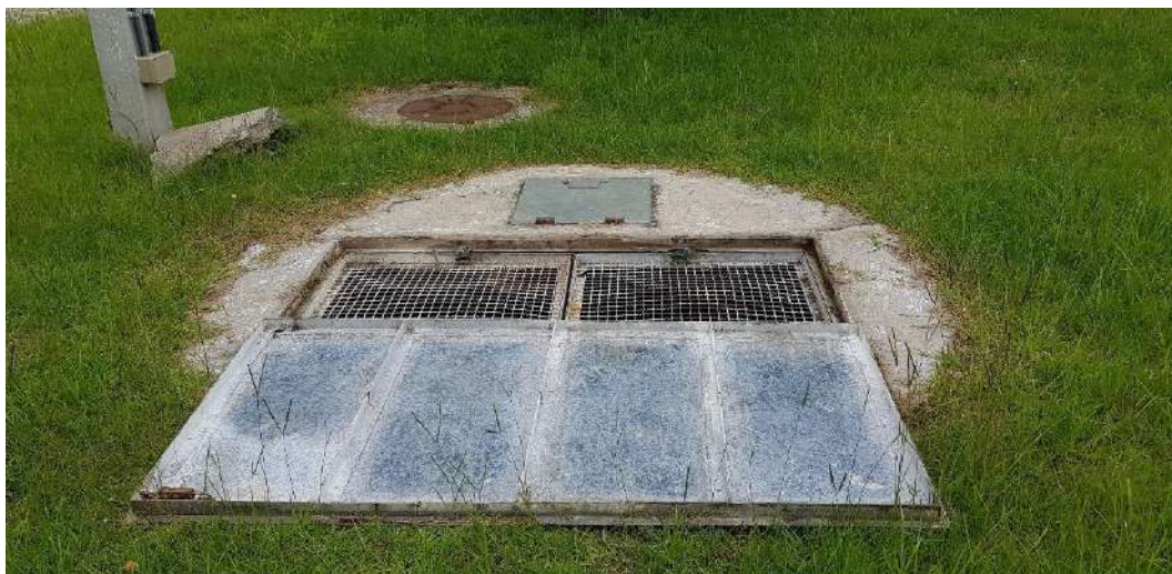
Figura 202 – Estação Elevatória Vila Bela. Fonte: PDE, 2011
