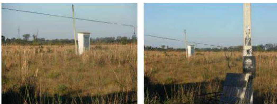
Figura 216 – EEE Espanha – Estação Elevatória Espanha. Fonte: PDE, 2011
