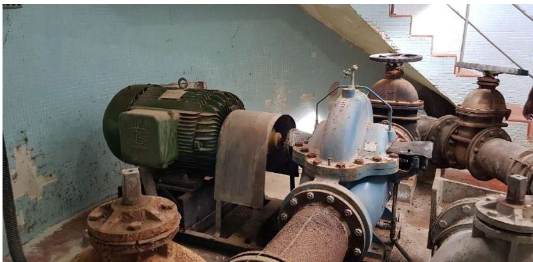
Figura 103 – Bomba da EEAT 3. Fonte: Biancade Engenharia
