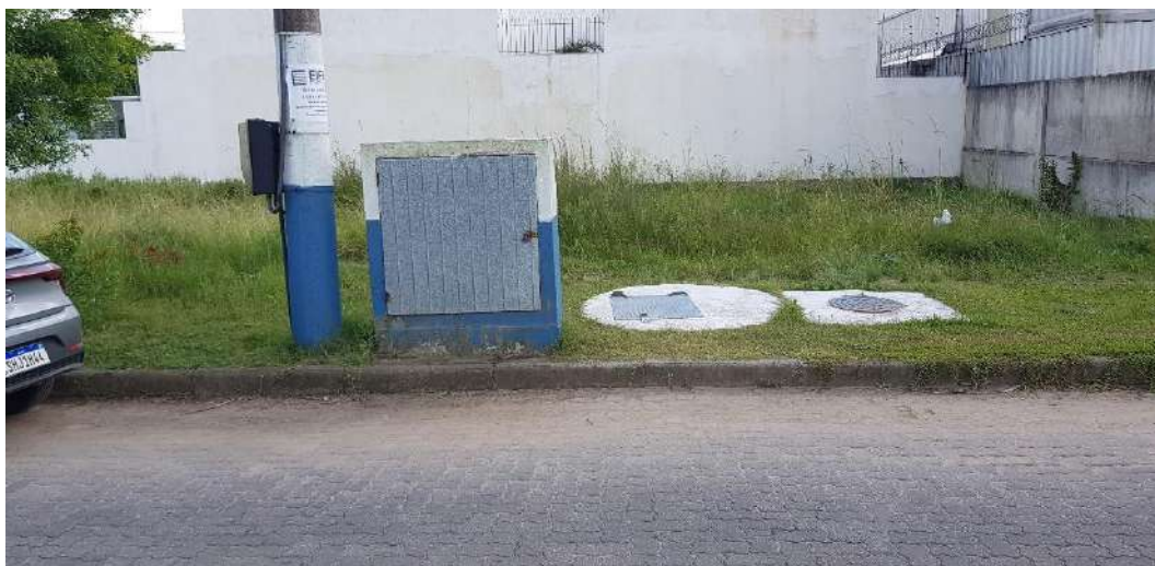
Figura 205 – Estação Elevatória Visconde da Graça. Fonte: PDE, 2011
